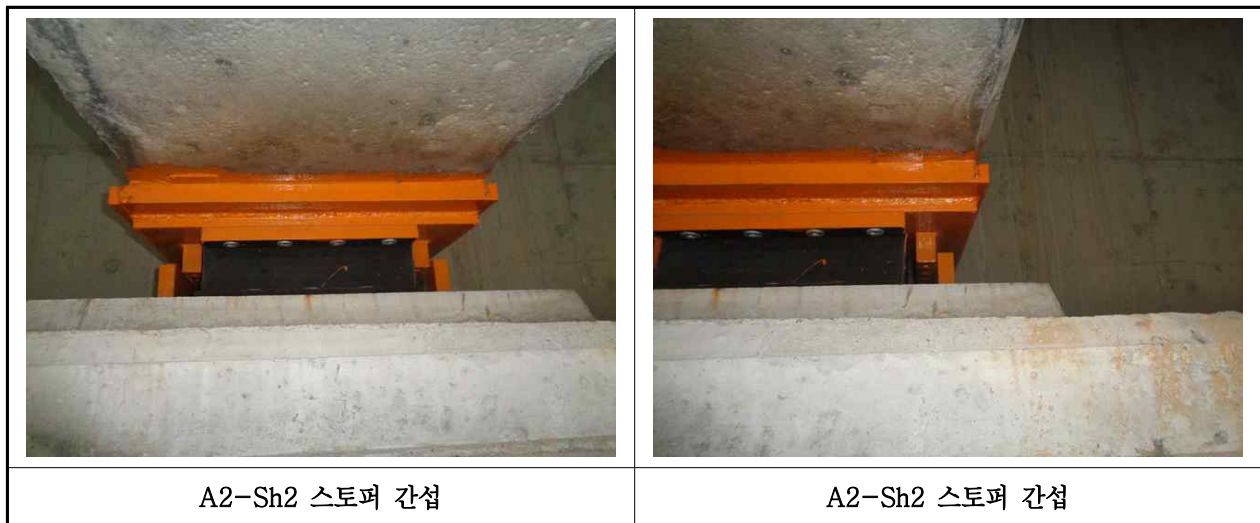
【사진 39.3.11】교량받침 손상현황
