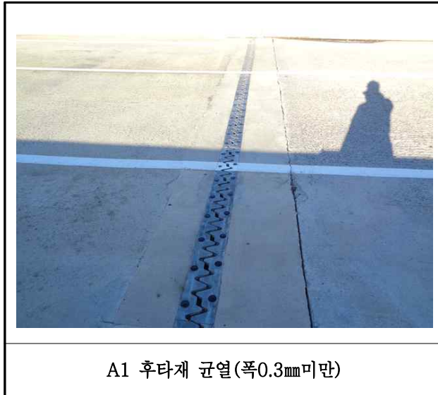
【사진 39.3.33】 신축이음장치 손상현황
