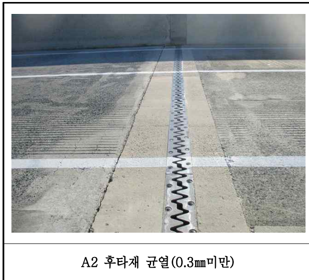
【사진 39.3.15】 신축이음장치 손상현황
