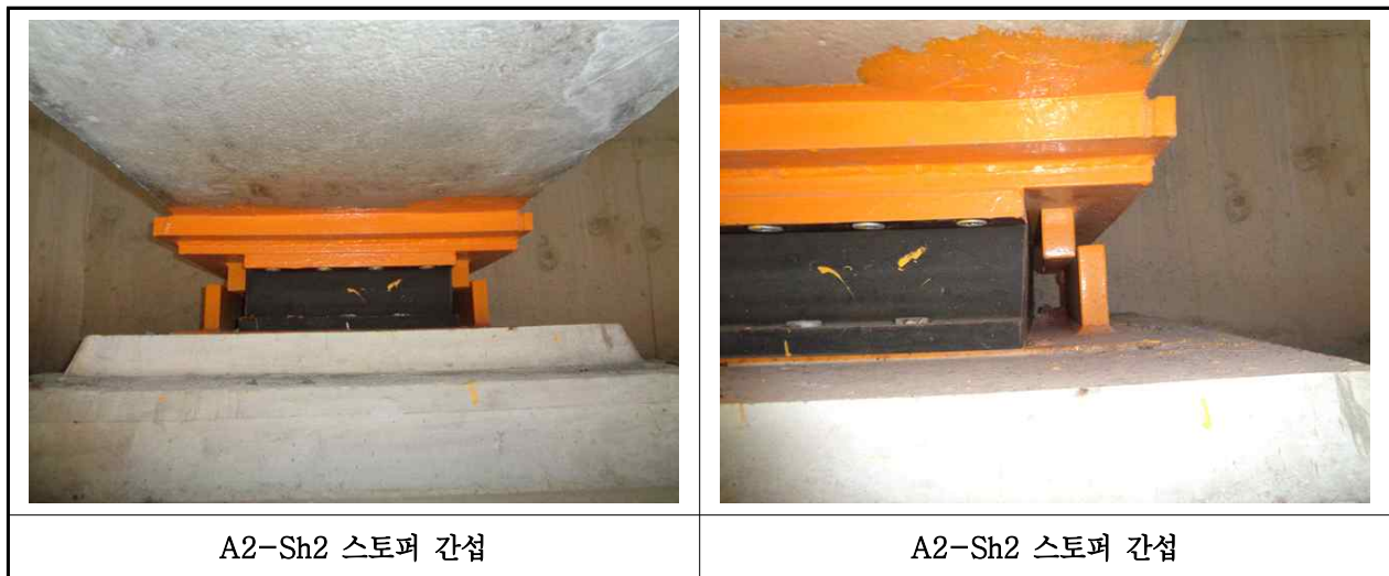
【사진 39.3.29】교량받침 손상현황
